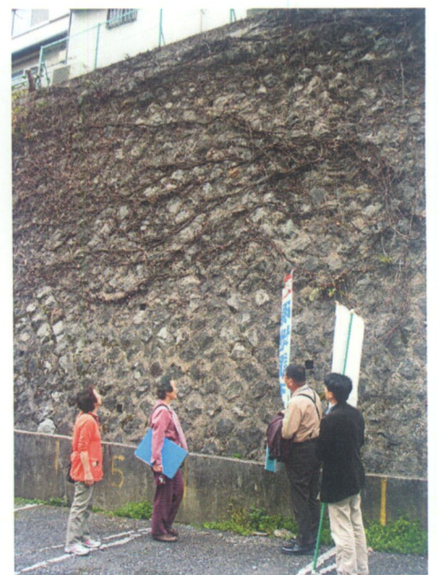
小日向2丁目と音羽1丁目との境の崖。「ひび割れがあり、木の根が生え出すなど崖の強度が大丈夫なのか心配です。他の崖地では大谷石が積まれただけのところもあり、きちんとした診断と対策が必要だと思いました」
